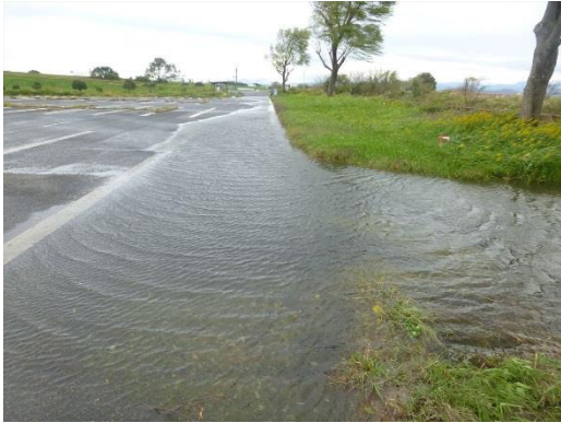
下宮駐車場浸水状況
